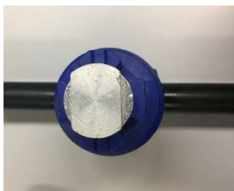
Figura 04A – Válvula fechada
